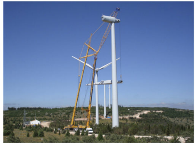
Parque Eólico de Monte Vez | Penela, Portugal
